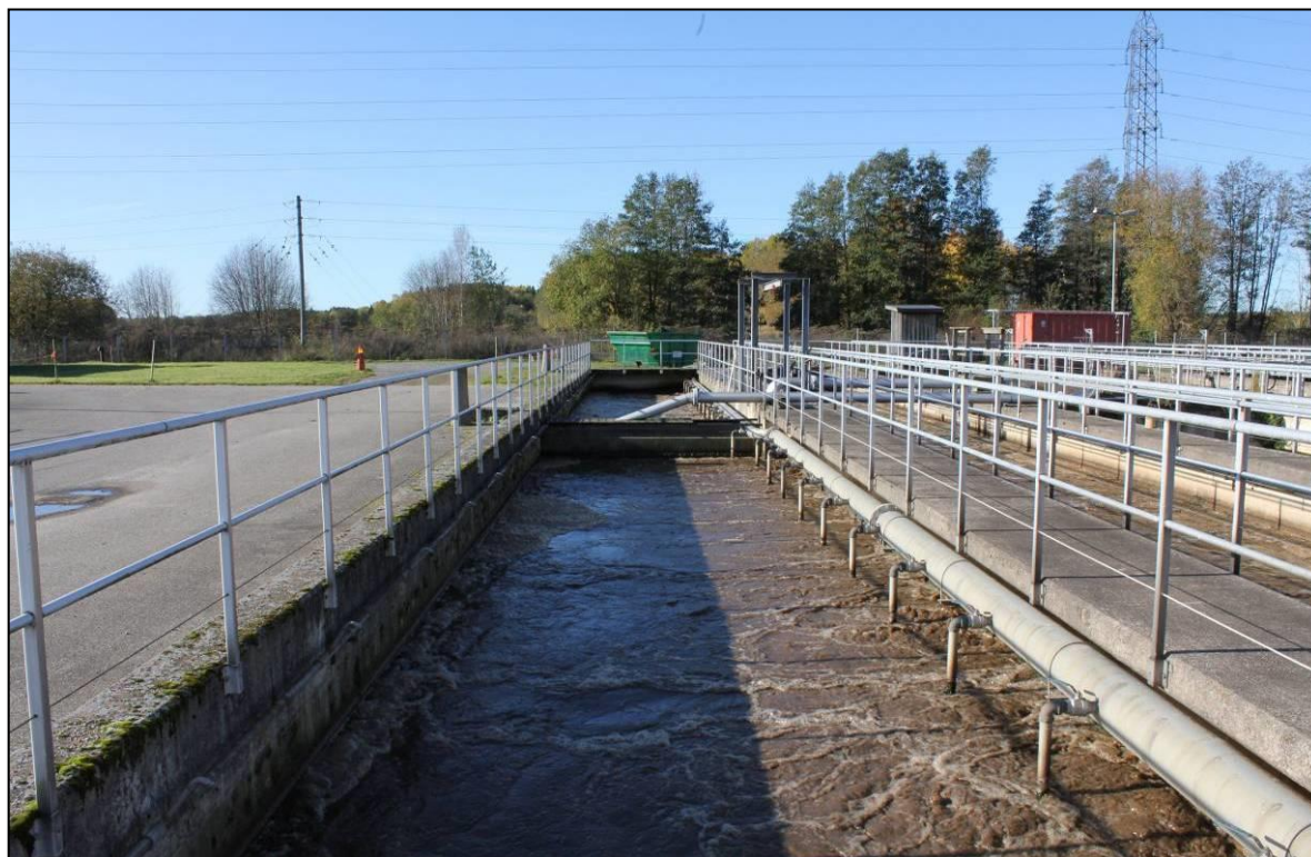
Bild 27: Reningsbassäng på Fors reningsverk. Foto: Hedda Ericsson
